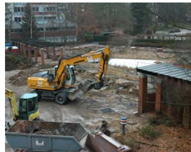
Baustelle am Botanischen Museum und Sumpf- und Wassergarten: Neubau für Dahlemer Saatgutbank für Wildpflanzenarten
