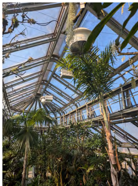
Neue Ventilatoren und Leuchten im Bromelienhaus.
